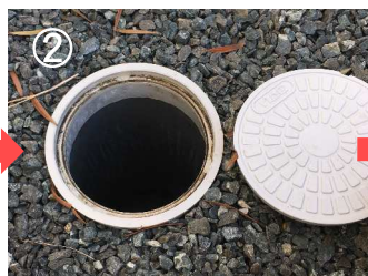
②フタを開けて、詰まってないか確認する。※詰まっていた場合は、ゴミを取り出して配管内を水で掃除しましょう。
